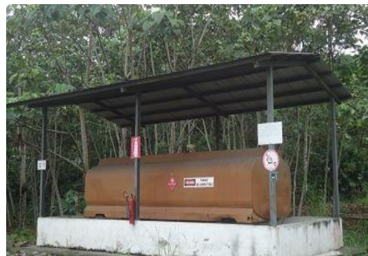
Ilustración 20 Área de almacenamiento de combustible.
